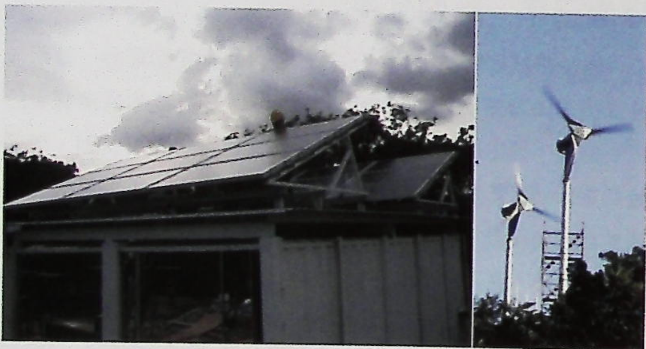
位於香港馬灣公園的風光互補發電項目。
